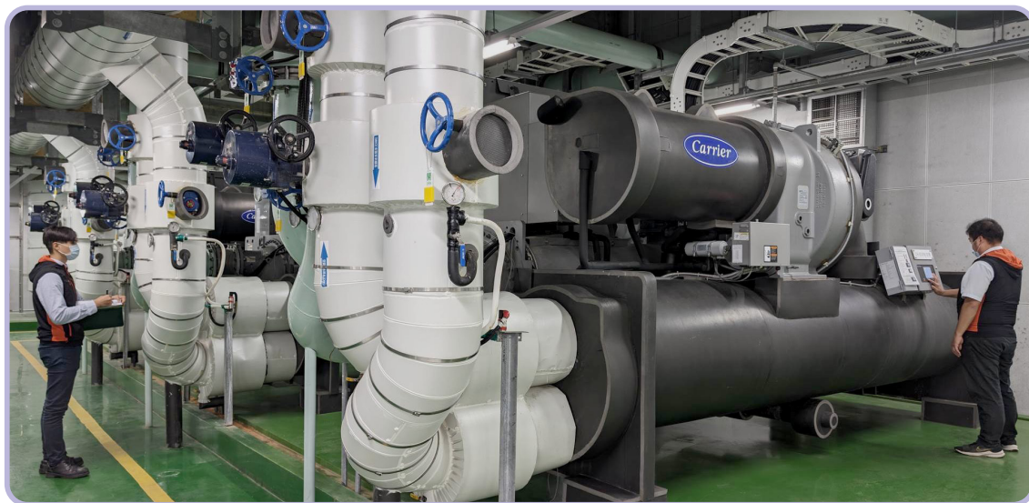
▲ 中央空調主機房採全變頻系統，搭配最佳化節能控制
